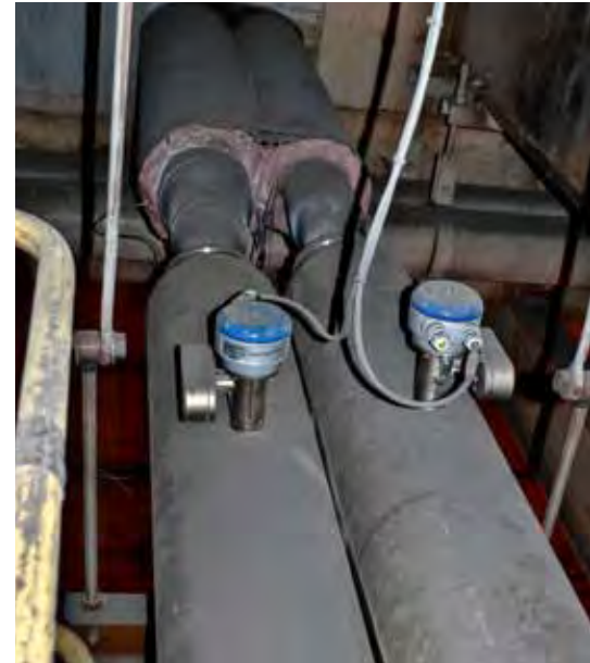
Mesure du débit-masse du mazout lourd
