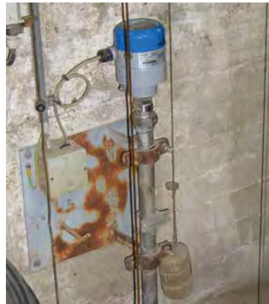
Transmetteur de niveau TDR en tant que protection anti-débordement dans un puits d'eau
