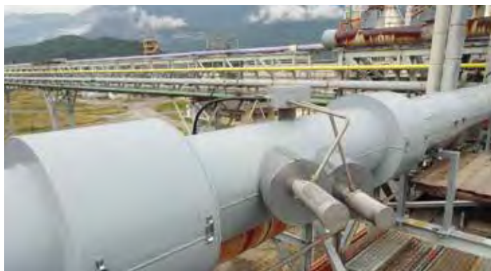
Mesure de débit à ultrasons sur la vapeur surchauffée
