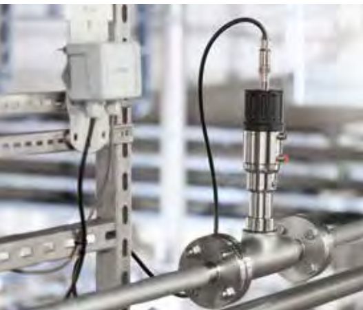
Système rétractable manuel pour sonde de pH dans une usine de produits chimiques
