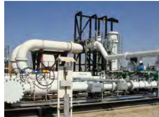
Système de mesure monté sur skid avec système de boucle étalon
